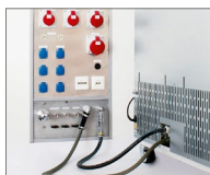
Direkter Anschluss an Reinstwasser-Druckleitung
